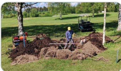
Kentän sadetusjärjestelmässä oli ongelmia putkiliitoksissa.
